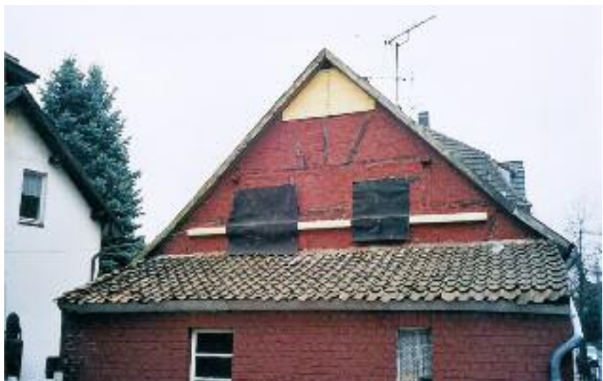
Zur Sicherung des Hauses wurden im Frühjahr 2008 Strebeneingezogen, die ein Wegbrechen der Giebel verhindern sollten
